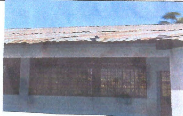
Foto 2: deterioro del techo
