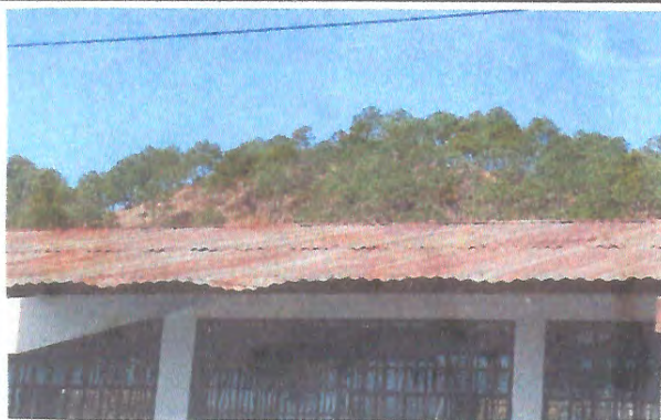
Foto 1: deterioro del techo
